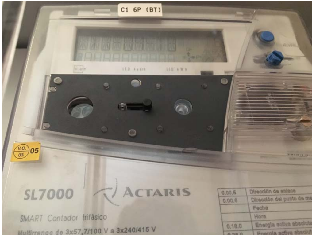
Ilustración 12. Contador del Restaurante Avenida
